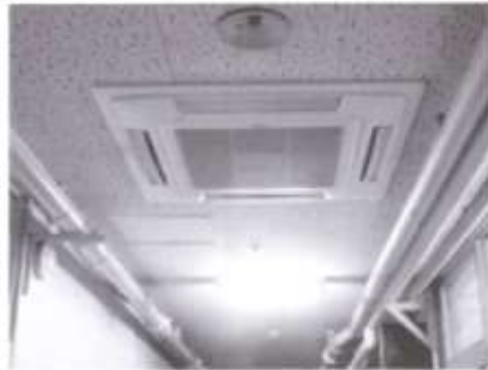
西棟の男子・女子の廊下に1台ずつ設置され涼しく過ごせました。
